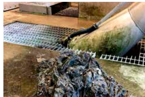
Släng våt- och städservetterna i soporna. Personalen på NSVA lägger mycket tid på att rensa bort våt- och städservetter som fastnat vilket leder till stopp.
